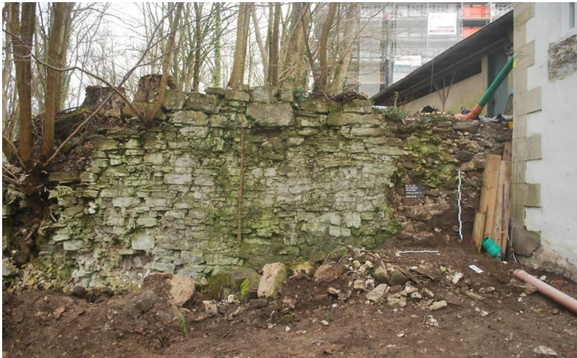
Foto: Erhaltenes Podest des ehemaligen Gefängnisses mit Blick auf die ruinöse südwestliche Außenmauer 2023; Dr. Meffert
